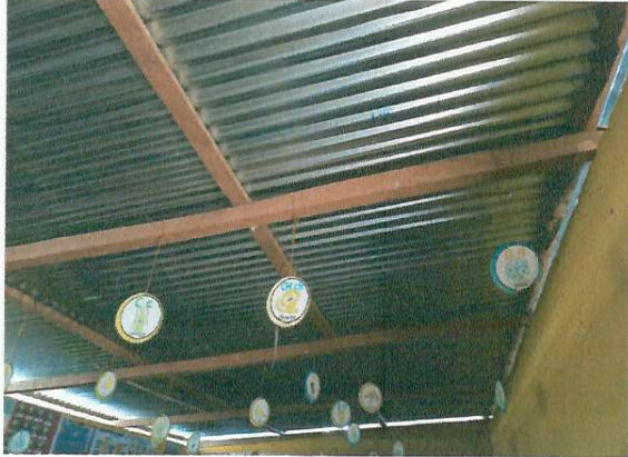
Foto1: Cambio de estructura de madera a metal y cubierta de lámina troquelada calibre 26 del módulo.
